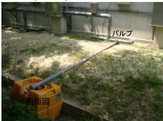
通気管を利用した排汁抜き取り装置
